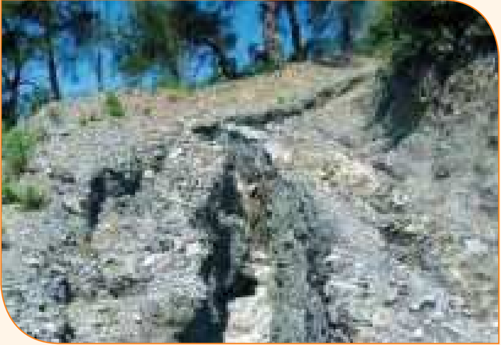
Resim 3.20: Alt Yapısı Tamamlanmamış Orman Yolu
